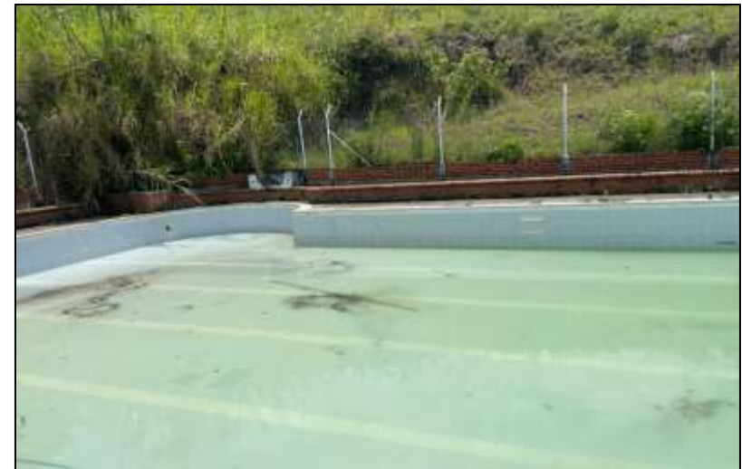
Imagen 2. Estado Piscina Municipal Florencia Cauca.
